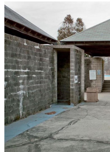
[52] ] Trenton Bath House : φθορά στους τοίχους από το νερό της βροχής
