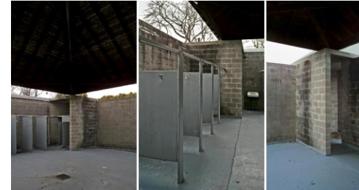
[80] Bath House : φθορά στα υλικά
