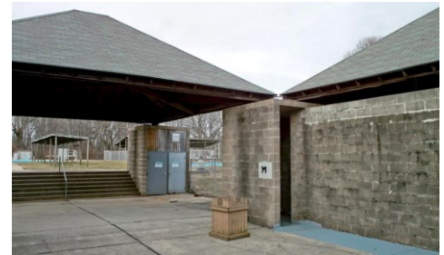
[62] Bath House : φθορά στις τοιχοποιίες
